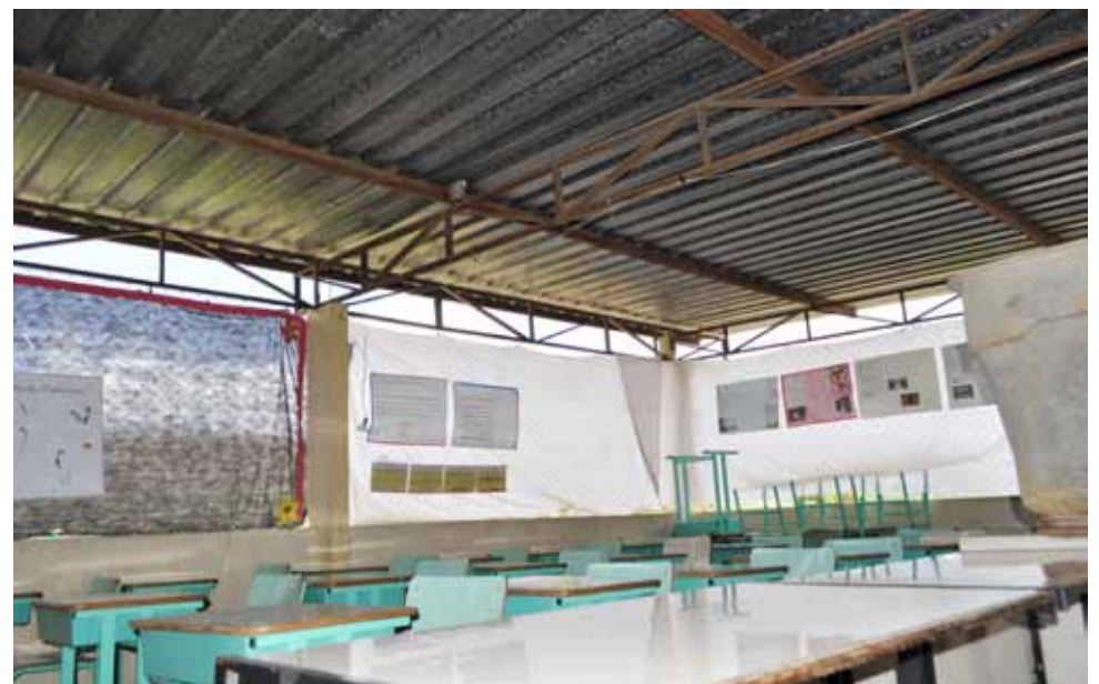
Terraço com telhado metálico e sem forro é desumano.
